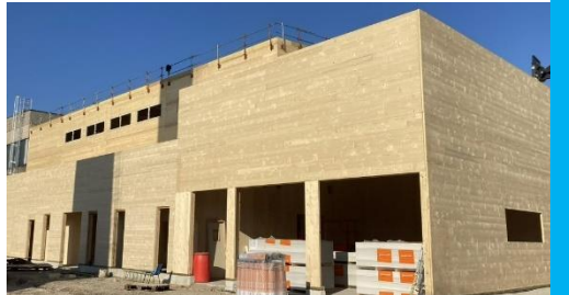
« New Thermal Treatment » project in Amiens, France
